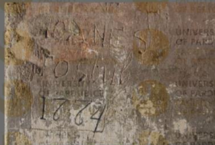
Mechanická poškození – škrábance, graffiti
